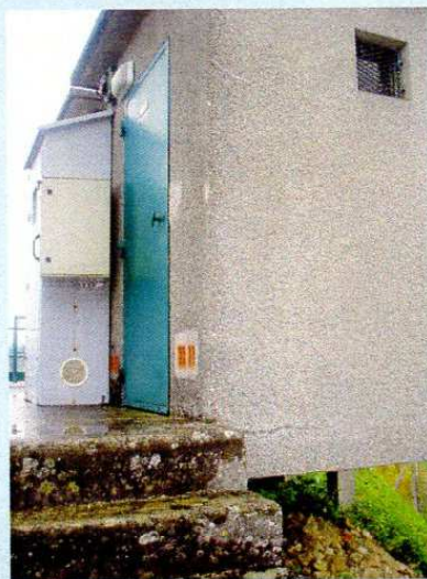
La station de pompage
