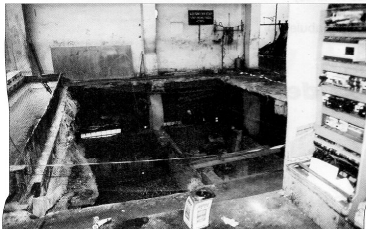
Usine T.M.P.E. sol effondré. Sous sol inondé
